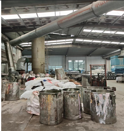
洗桶区及干法配料间喷淋塔
